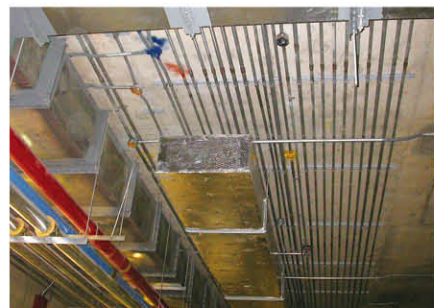
消防電線用管
