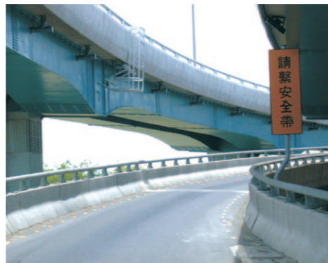
高速公路護欄 Highway Guardrail
